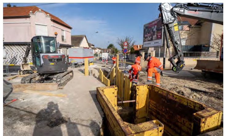
9. Avenue de Berny et rue de Ruzé, rue de Ruzé, en lien avec l'assainissement du troisième collège, d'agglomération Roissy Pays de France (CARPF) mène depuis février des travaux d'assainissement, en séparant les réseaux d'eaux usées et d'eau pluviale. Pour cela, la voie a été barrée, et une tranchée ouverte, profonde jusqu'à 5 mètres.
