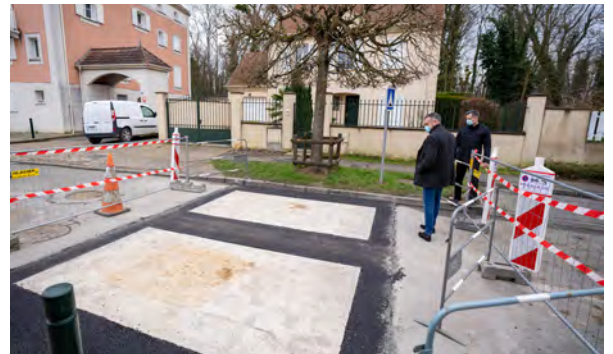
7. Rue des Tilleuls (à Boisparisis), des ralentisseurs ont été transformés en deux fois deux coussins berlinois bétonnés.
